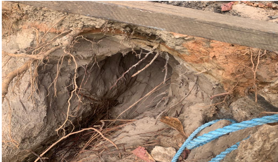
Imagens 6 - Demonstram a consequência de um ponto onde ocorreram as infiltrações pelo vazamento da tubulação da EMBASA.
